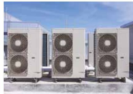
Fläkt- och Luftåtervinningsaggregat
