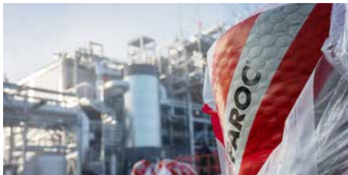
PAROC nätmattor spar energi i biogasanläggningen Cortus Högnäs.
